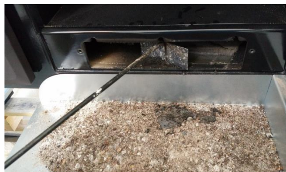
Figura nº20 - Acessos para a limpeza da saída de fumos.
