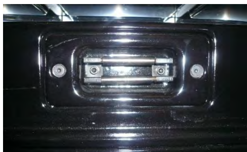
Figura n°21 - Accesos para la limpieza de la salida de humos.
